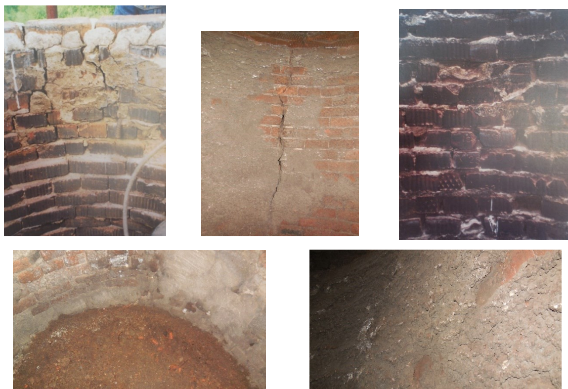
Рис. 3. Дефекты и повреждения внутренней поверхности трубы
