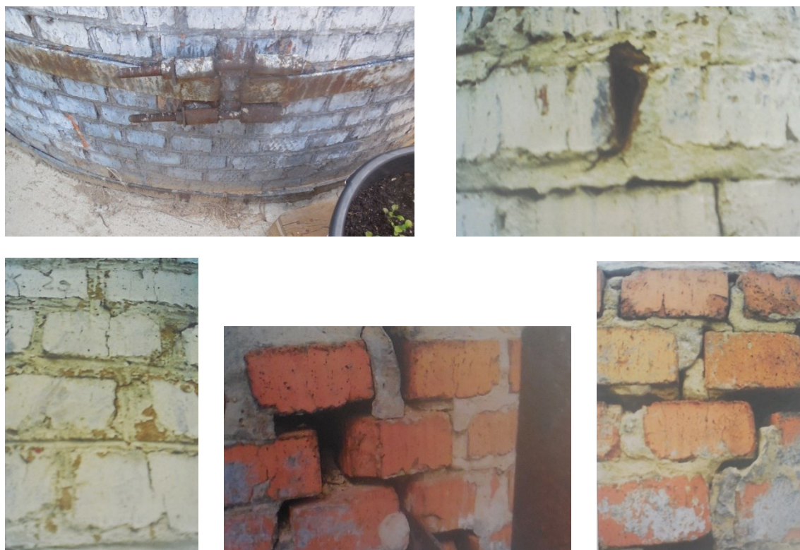
Рис. 2. Дефекты и повреждения наружной поверхности трубы
