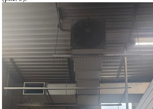
Рис. 1. Приточно-вытяжная вентиляция всего помещения цеха
